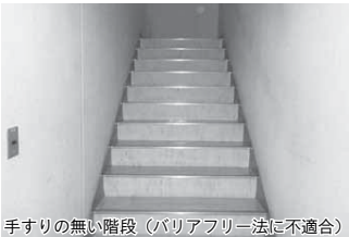
手すりの無い階段(バリアフリー法に不適合)
