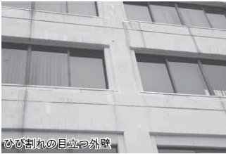
ひび割れの目立つ外壁
