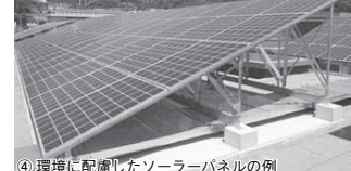
④環境に配慮したソーラーパネルの例
