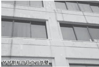
ひび割れの目立つ外壁
