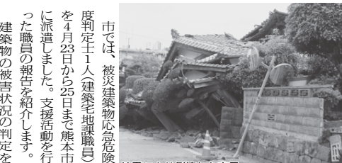
地震により倒壊した家屋
