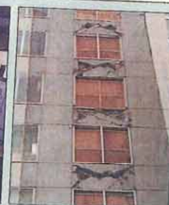
梁せん断破壊
