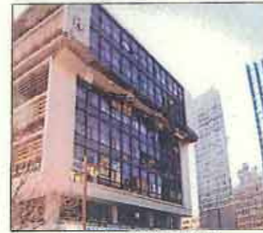
中間層(6階)の崩壊
