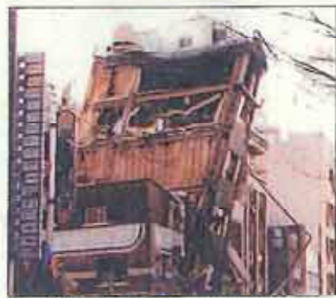
鉄骨造フレームの大変形
