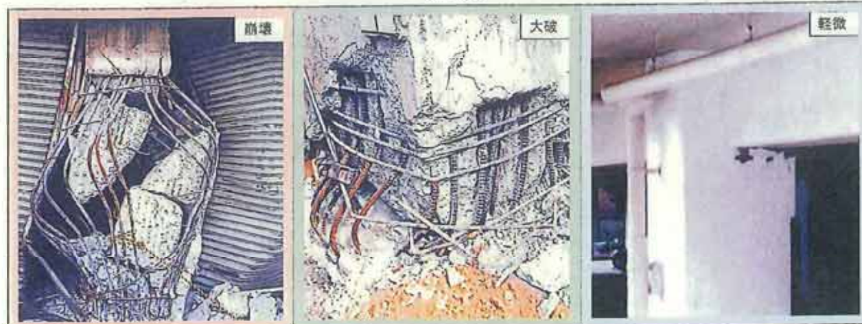
柱がせん断破壊した集合住宅 柱が曲げ破壊した雑居ビル 柱の被害が軽微であった集合住宅
