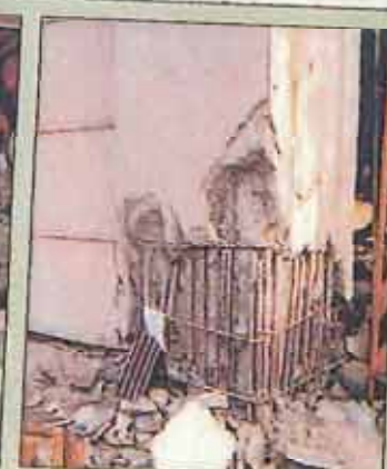
柱付着割裂破壊
