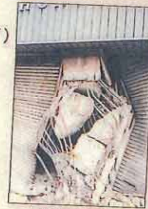
柱せん断破壊
