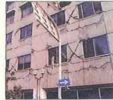
短柱のせん断破壊
