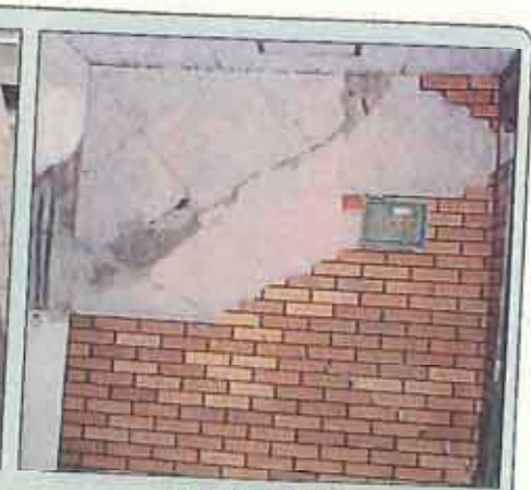
壁せん断破壊
