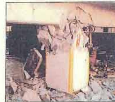
ピロティ柱頭の崩壊
