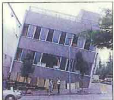
宮城県沖地震(1978) [ピロティ部分の崩壊]
