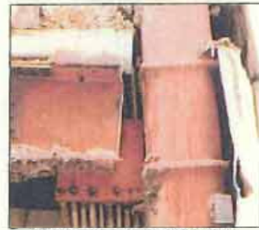
鉄骨造柱・梁接合部の破断
