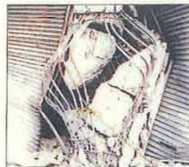
柱のせん断破壊
