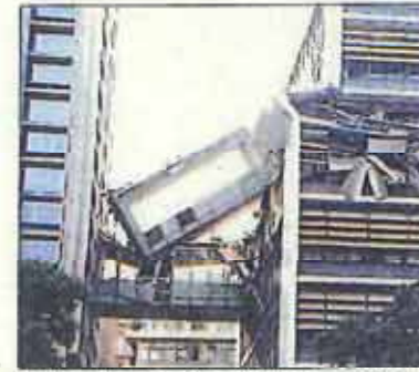
中間層崩壊に伴う渡り廊下の落下
