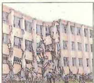
十勝沖地震(1968) [短柱のせん断破壊]
