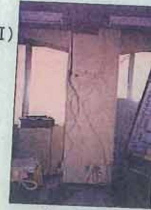
柱せん断破壊
