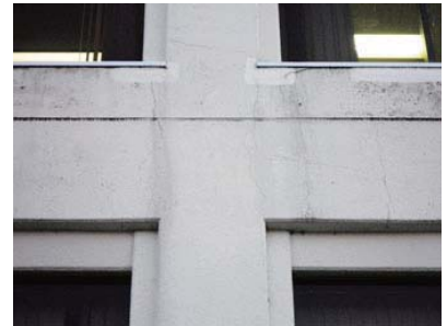
外壁の劣化状況 (クラックあり)
