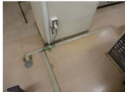
床上に露出した執務室の配線
