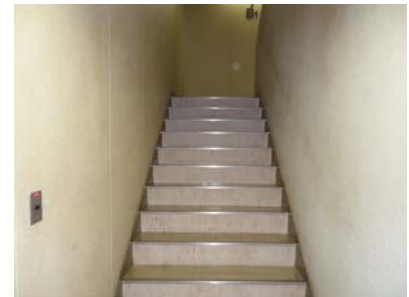
手摺が未整備でバリアフリーに対応できていない階段
