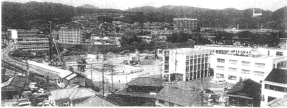
茨城県日立市では現庁舎（中央右）の隣接地で新庁舎の建設工事が進む
