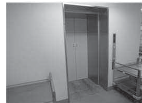
*1 エレベーター
