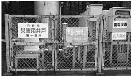
文化センター設置の非常用井戸
