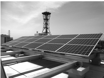
新築棟屋上のソーラーパネル
