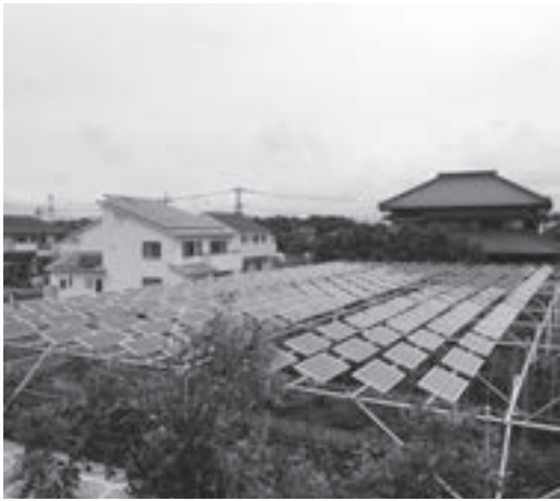
市内の営農型太陽光発電設備
