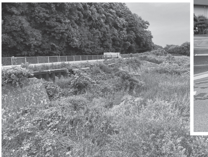
近年のゲリラ豪雨で崩れた法面擁壁(P.8-②)名内地先
