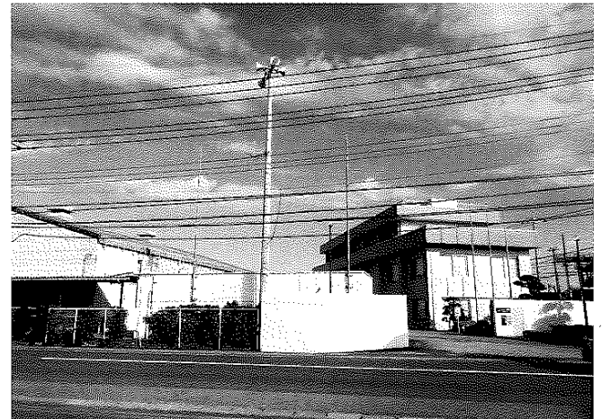
移設予定の防災無線設備
