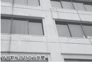
ひび割れの目立つ外壁
