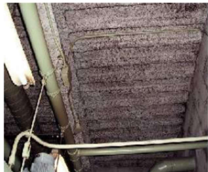
天井断熱材、天井、壁吸音材
