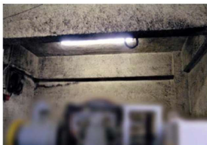
機械室吸音材
