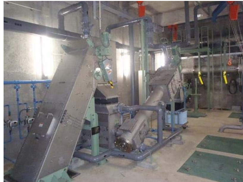
七次中継ポンプ場（内部）
