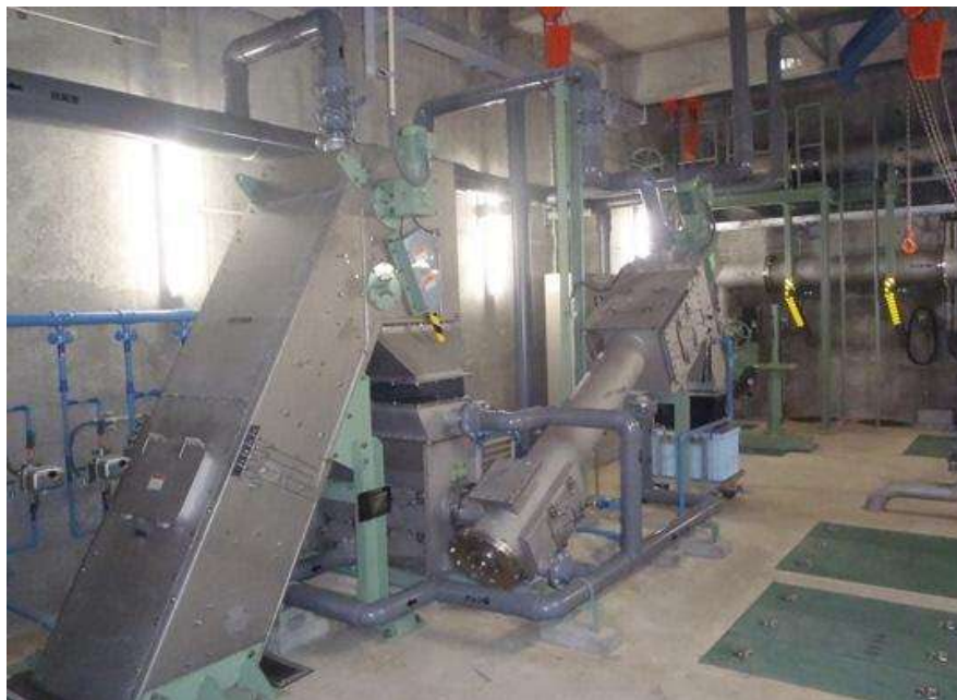
七次中継ポンプ場（内部）
