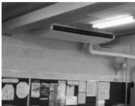
普通教室の空調設備
