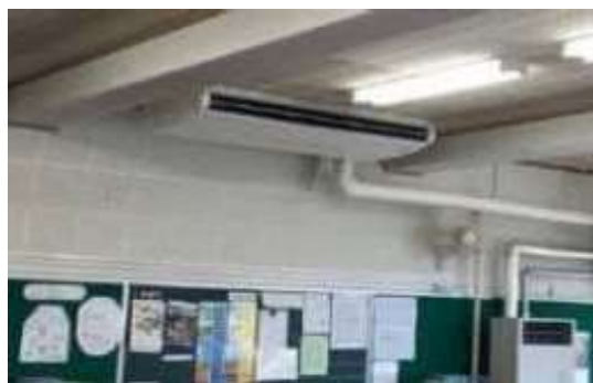
普通教室の空調設備
