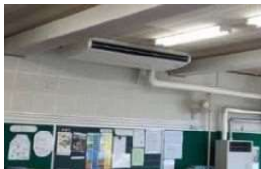
普通教室の空調設備
