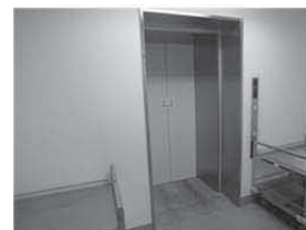
*1 エレベーター
