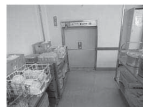
*2 エレベーター
