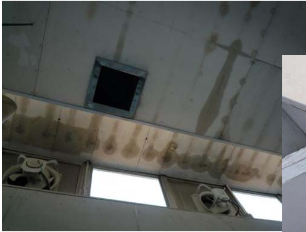
雨漏りの様子
