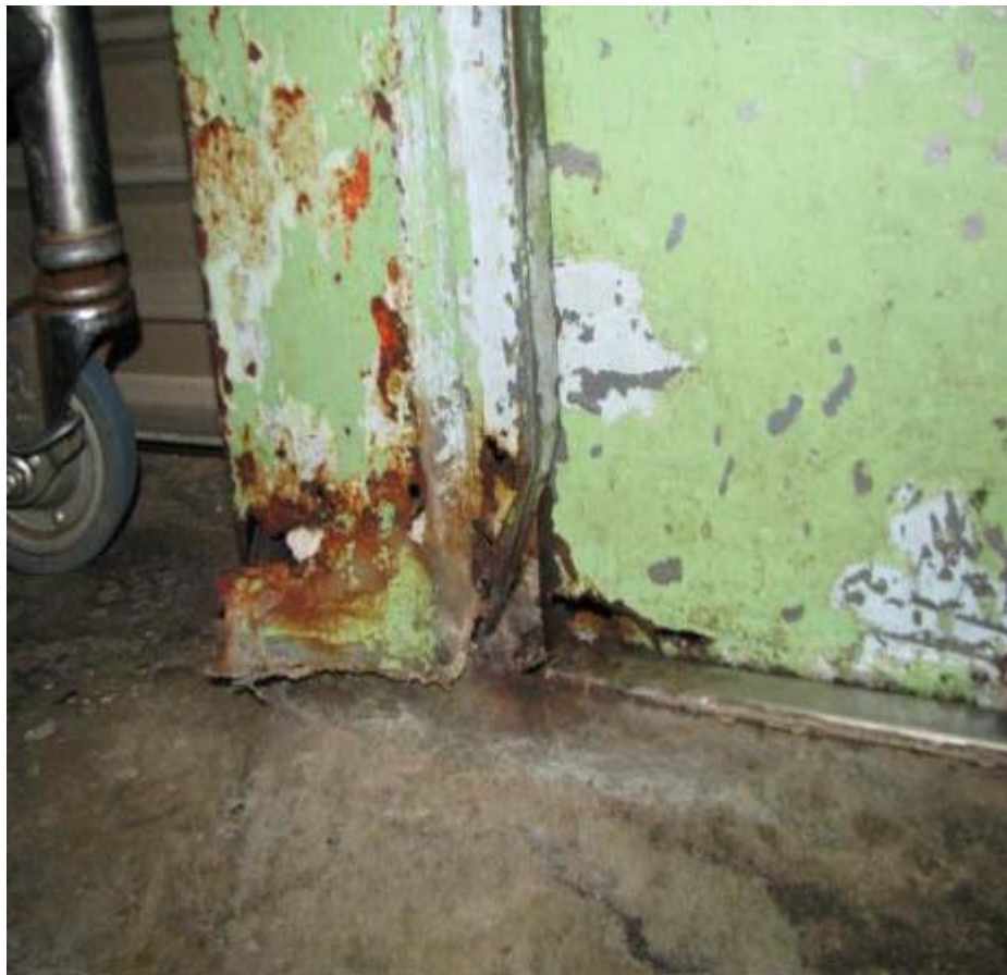
腐食している壁
